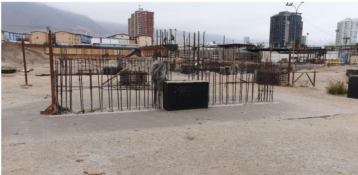
Foto 3.- Armaduras expuesta a la intemperie con oxidación superficial.
