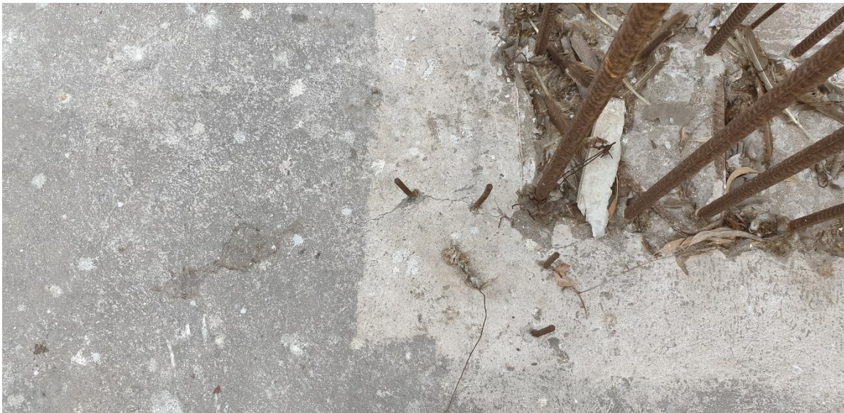
Foto 5.- Presencia de fisuras en la base de la fundación sin sello protector.
