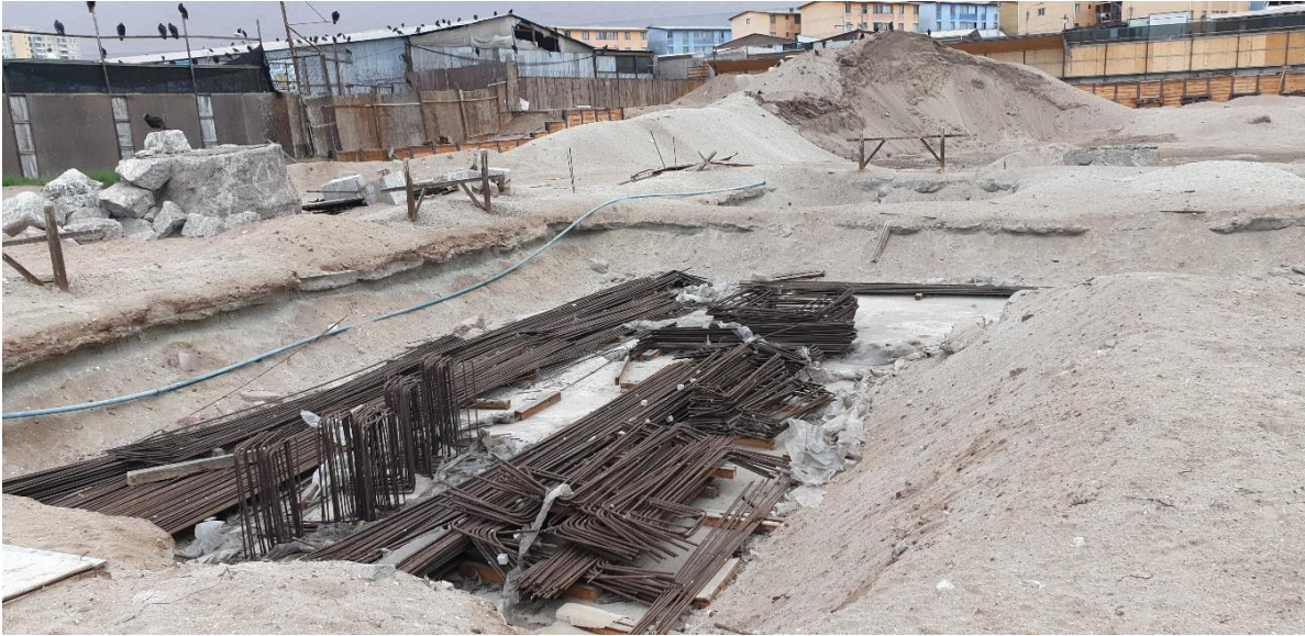
Foto 4.- Armaduras sobrante de la construcción expuesta.
